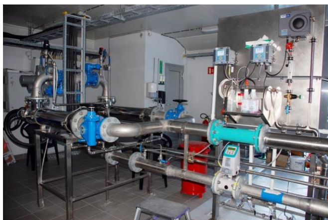
Vannbehandlingsanlegget i Dirdal. Anlegget er basert på UV og pH-justering
