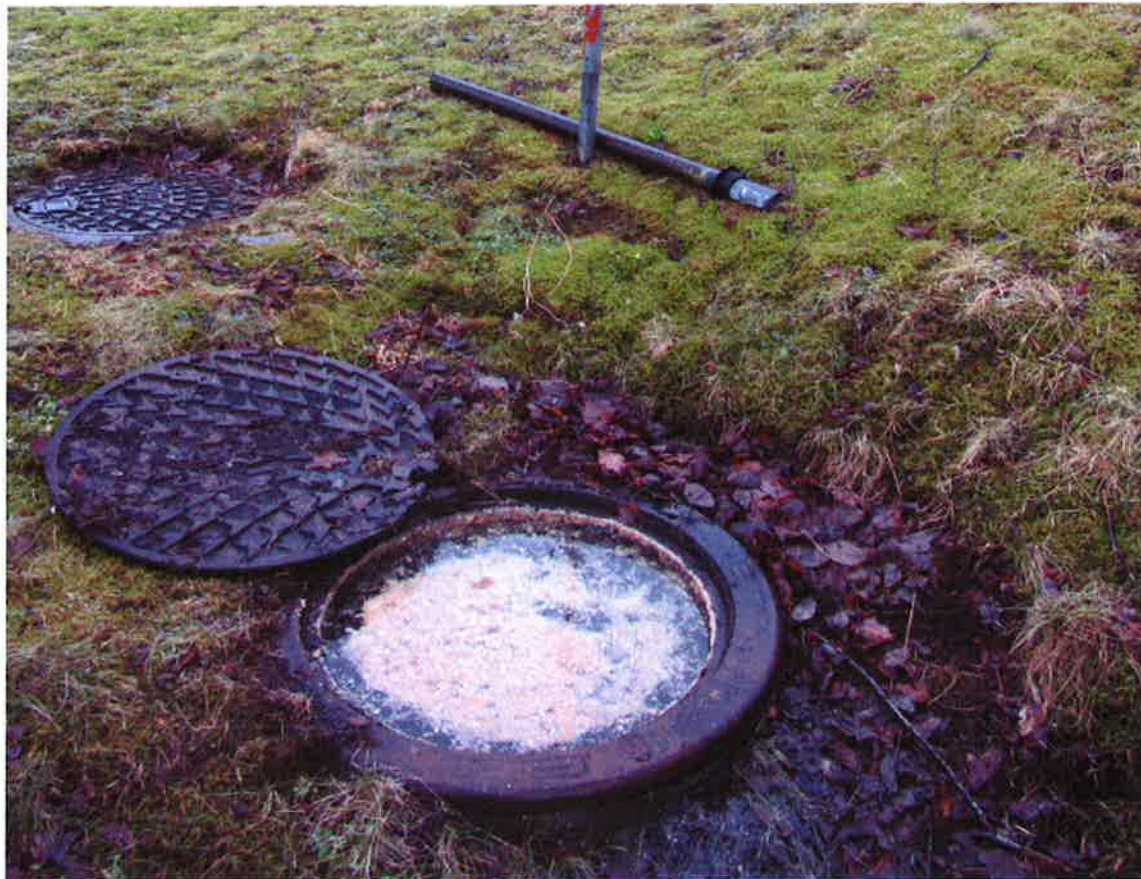
Avløp tett pga fett:
